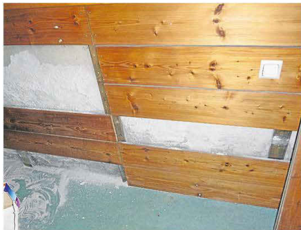
Nach dem Kauf ihres „Traumhauses“ entdeckte Familie K. im Keller hinter den Holzpaneelen die Schäden an der Wand. Um solche „Überraschungen“ zu verhindern, empfiehlt es sich, bei der Hausbesichtigung einen Sachverständigen zu Rate zu ziehen.
