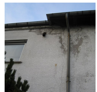
Fotos: Beispiel für konstruktionsbedingte Risse
