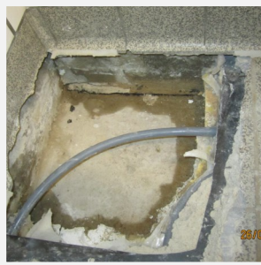
Probeöffnung im Kellerboden, sichtbare Feuchtigkeit unter dem Estrich
