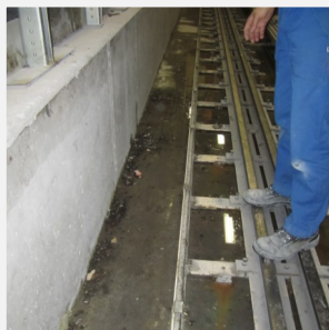
Sichtbarer Wassereintritt im Gleiskanal
